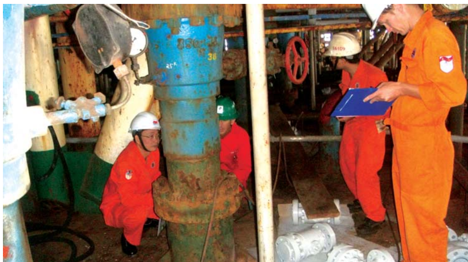
Hình 2. Khảo sát cây thông, đầu giếng kiểu OKK và AFK đã sử dụng gần 30 năm
