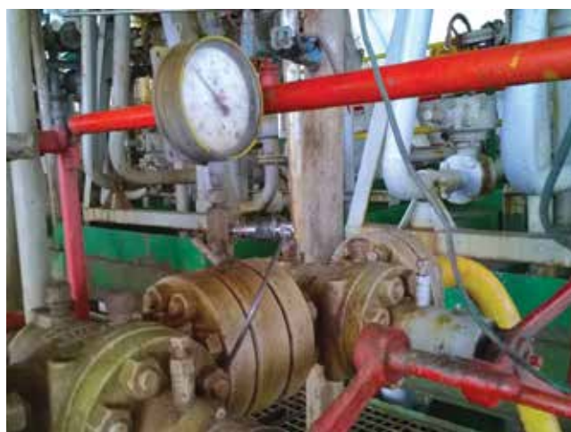
Hình 3. Vị trí lắp đường bơm hóa phẩm vào đường khí gaslift.
